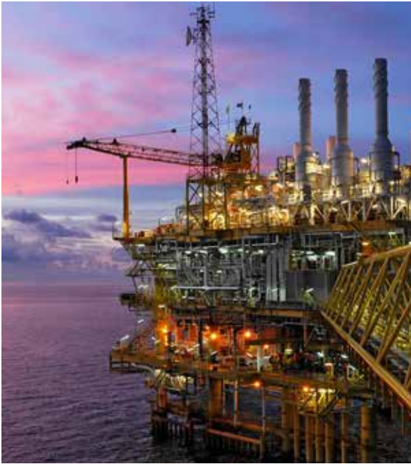
海上石油平台
