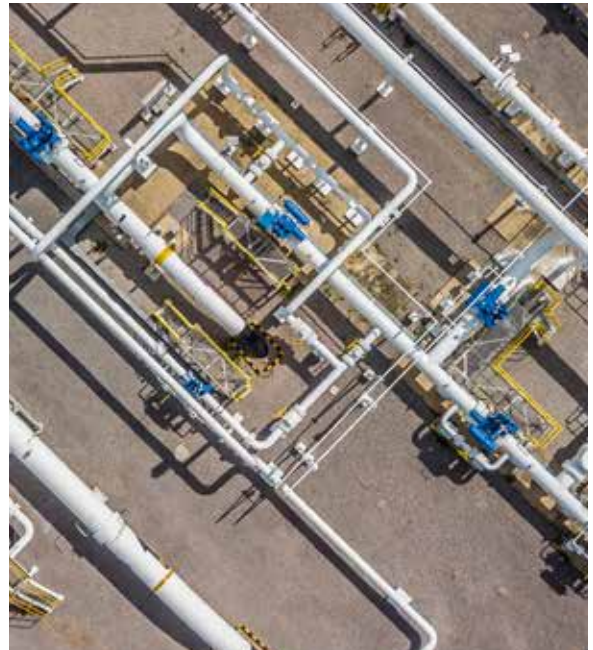
油气输送管道
