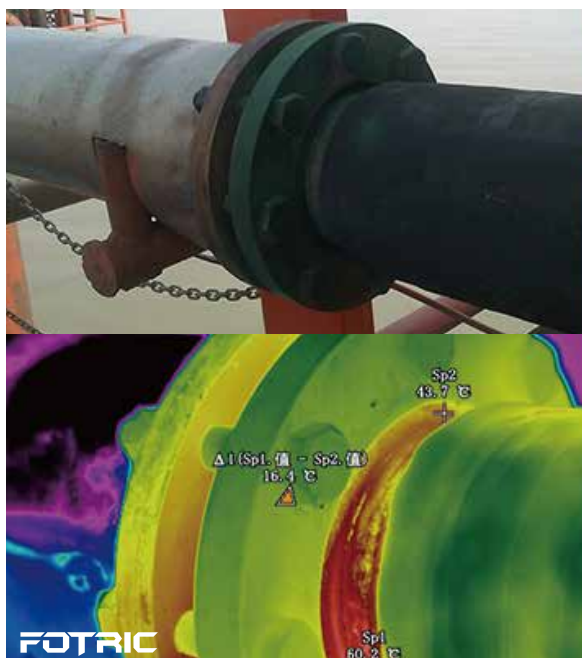
管道法兰连接处老化
