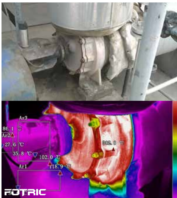
导热油泄漏检测
