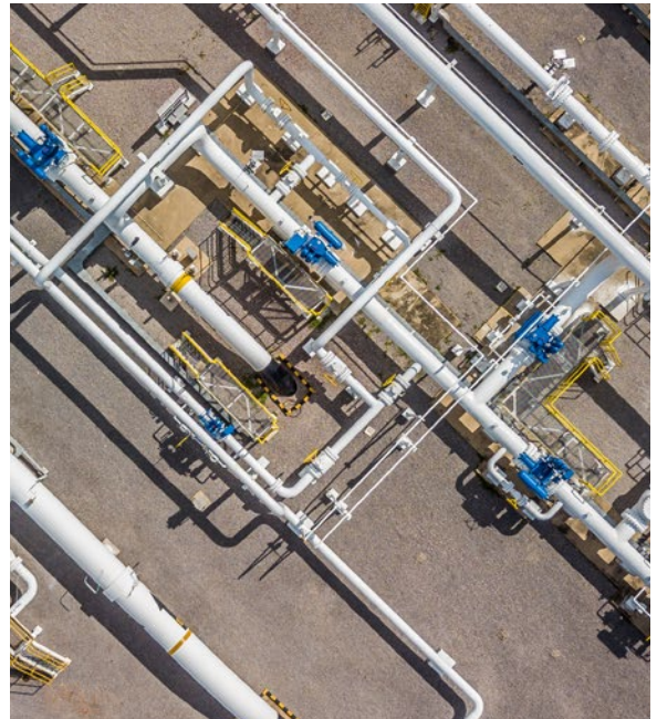
油气输送管道
