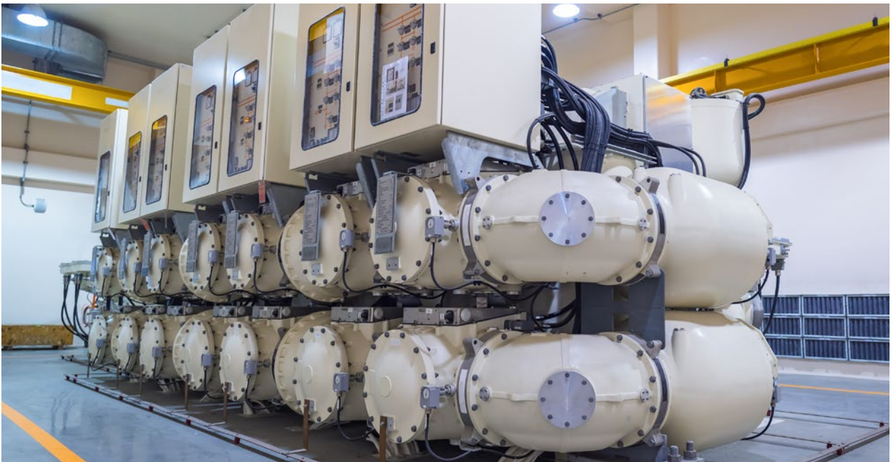
GIS高压开关柜
